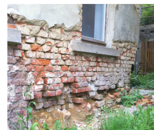
Hier wurde zu lange gewartet! Ständige aufsteigende Feuchtigkeit hat den Mörtel zerstört.
